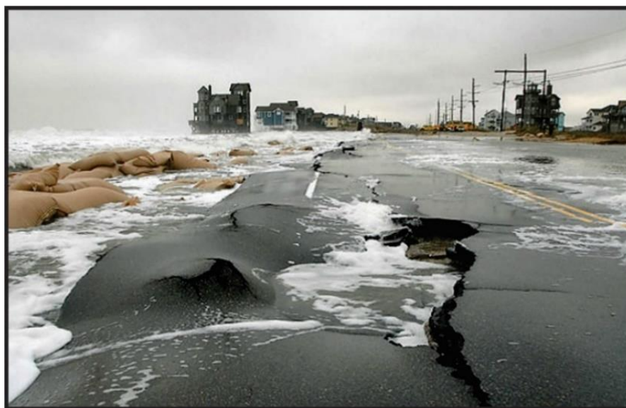
Figura 30. Danos no pavimento devido a ondas e marés em um evento extremo na Carolina do Norte-USA (fonte: Departamento de Transportes da Carolina do Norte e dos EUA).
