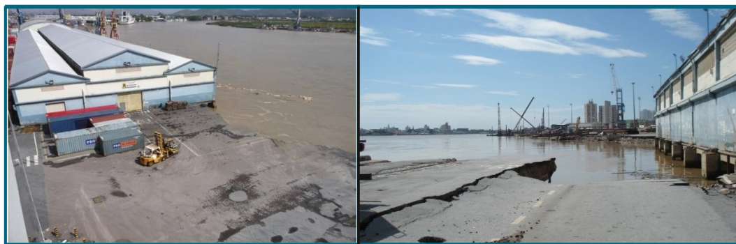
Figura 10. Danos sobre os berços de atracação do Porto de Itajaí (SC), após os efeitos de inundação no Rio Itajaí-Açu em 2008. Fonte: PORTO DE ITAJAÍ (2008).
